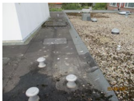
Slechte staat dakbedekking
